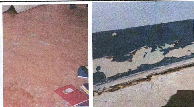
Foto 3: PISO CON GRIETAS Y EN MAL ESTADO
